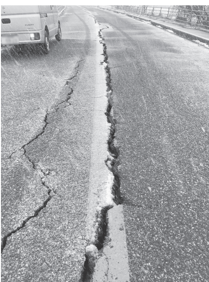
▲地震の影響で、あちこちの道路で大きな亀裂が生じていた。
